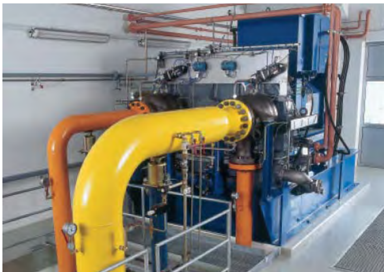
Abbildung 19: Zweistufige Erdgasentspannungsturbine in Arlesheim (Quelle: Gasverbund Mittelland AG)
