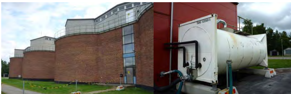
Abbildung 8: Beispiel für Co-Fermentation von biogenen Abfällen gemeinsam mit Klärschlamm in Schweden (Quelle: New Energy)
