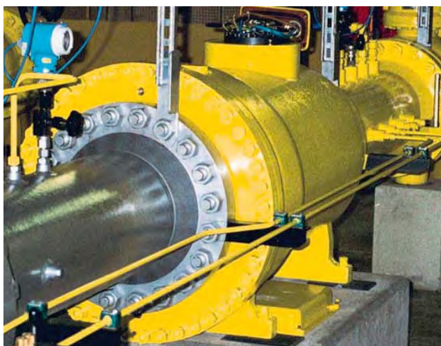
Abbildung 24: Eingebautes "Expansion Power Module" (Quelle: KK & K)
