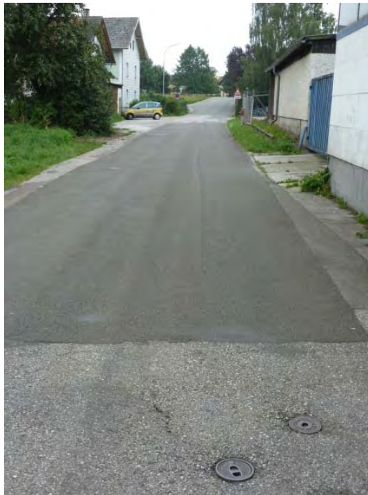
Abbildung 28: Zustand einer Gemeindestraße vor und nach Einbau der Reaktivasphalt-Deckschicht (nach einer Liegezeit von 2 Winterperioden )
